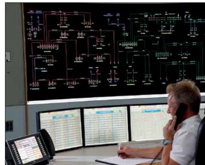
...schlägt das technische Herz der Strom- und Gasnetz in der Gladbecker Netzleitstelle. Hier wird rund um die Uhr für die Sicherheit der Energieversorgung Sorge getragen.
